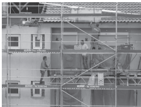
Renovacija: asbesto turinčios dangos - pavojingos sveikatai
