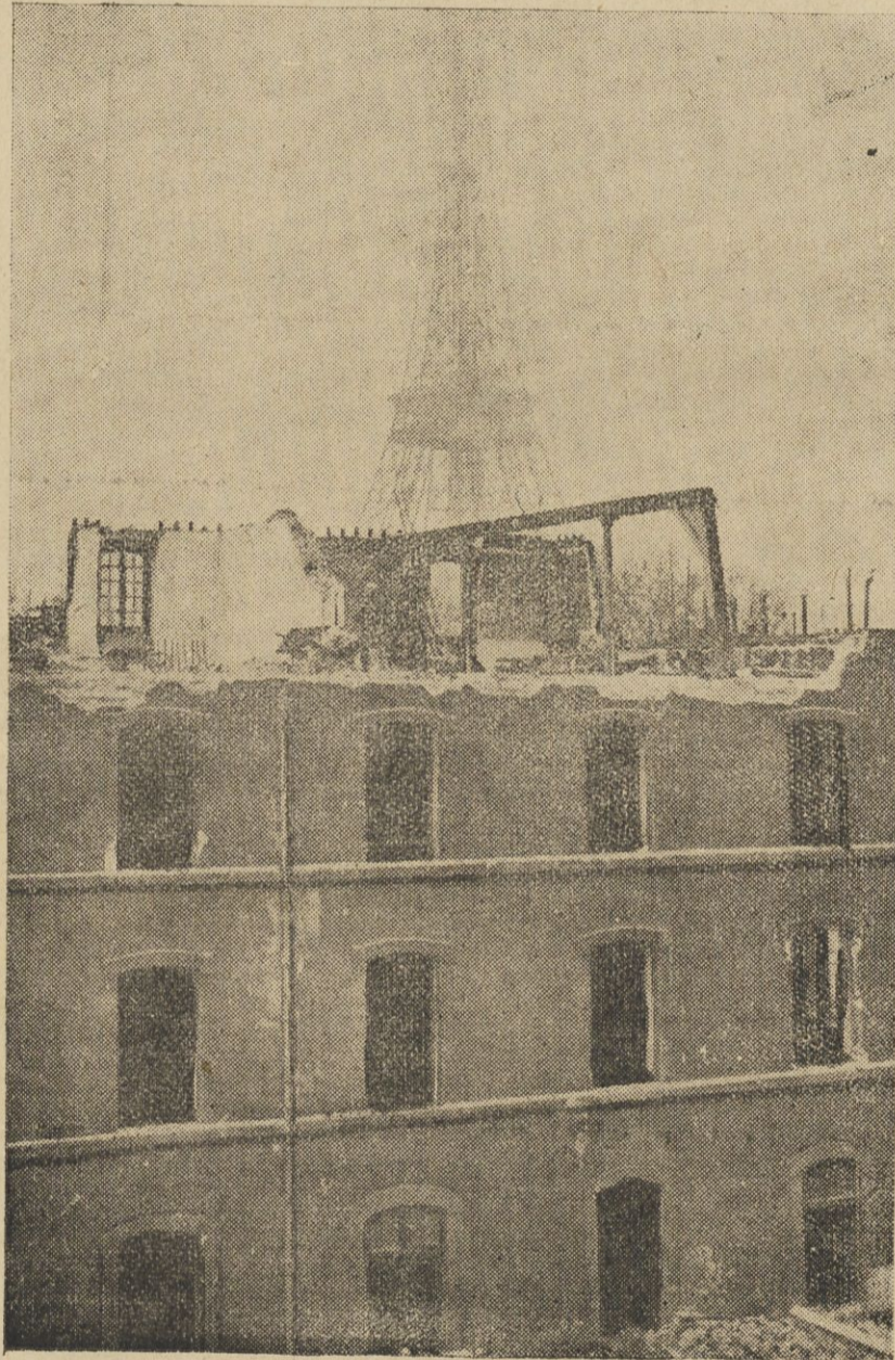
W Paryżu w r. 1937 ma się odbyć międzynarodowa wystawa do której czynione są już przygotowania. Na ilustracji: burzenie domu znajdującego się na przyszłym terenie wystawy.
