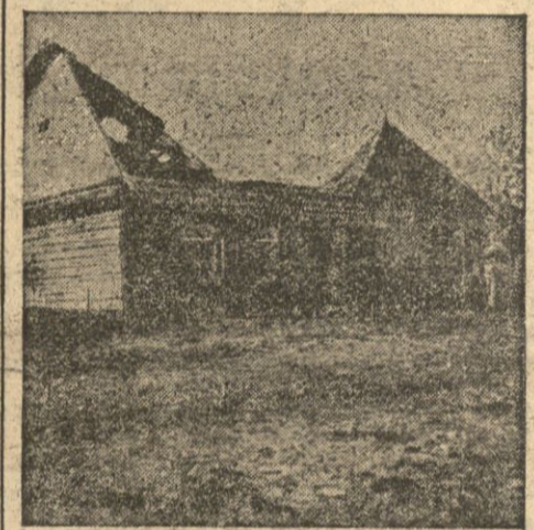
Dom mieszkalny z zerwanym dachem.
