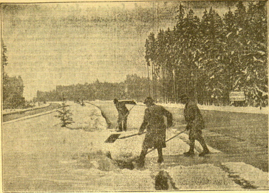
In Südbayern ist der Winter eingezogen Weiße Strecken Baherns haben in diesem Jahr zum erstenmal ihr Winterkleid bekommen. In den hohen Bergen schneite es bereits beträchtlich. Hier sieht man, wie die Reichsautobahn in der Nähe des Mühlbals vor den Toren Münchens von ihrer ersten Schneedecke befreit wird. Schneepflüge und Schneeschaufler sorgen für eine stets gute befahrbare Strecke.
