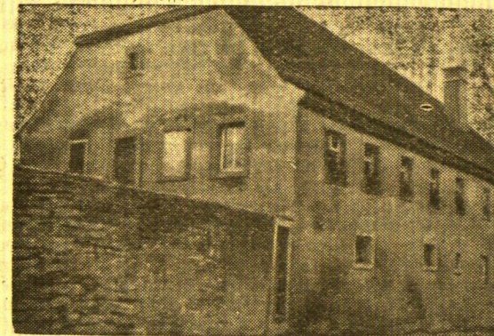
Wie Ställe nicht sein sollen! Durch fehlende Entlüftung feuchtes Mauerwerk
